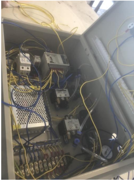
รูปที่ 9 wiring ตู้คอนโทรลเสร็จแล้ว
