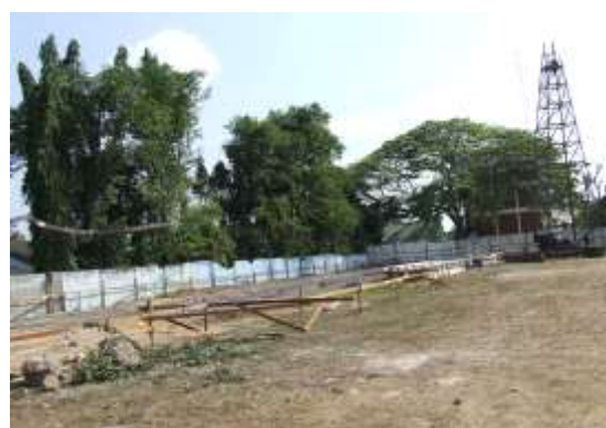
รูปที่ 2.19 หลังจากการวางผังเสร็จเรียบร้อยแล้ว จึงสามารถดำเนินขั้นตอนต่อไปได้
