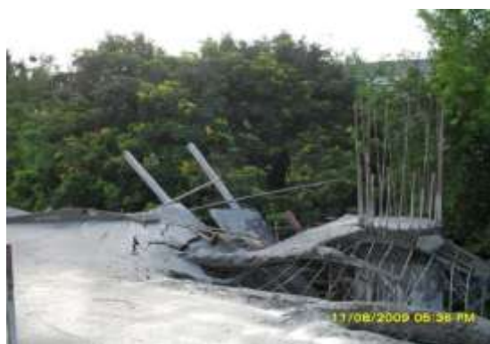
รูปที่ 2.29 จากการตั้งนั่งร้านไม่ดีจะทำให้พื้น ถล่มลงมาและเกิดความเสียหาย
