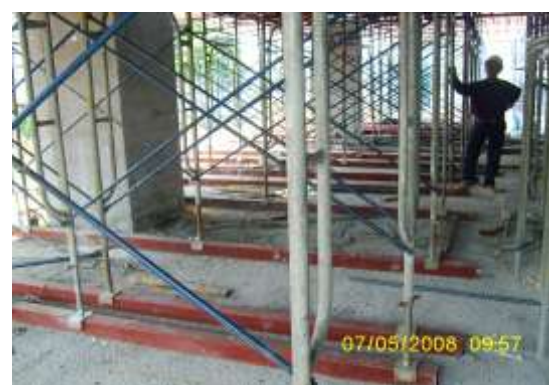
รูปที่ 2.23 การตั้งนั่งร้านหรือค้ำยันจะต้องมี plate รองรับเพื่อให้เกิดความมั่นคง
