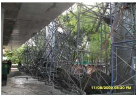
รูปที่ 2.28 การตั้งนั่งร้านต้องมีความมั่นคง และแข็งแรง ไม่อย่างนั้นจะทำให้นั่งร้านพัง
